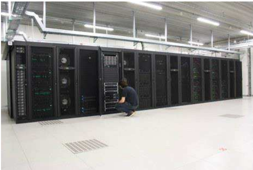
Zicht op de Tier2 rekeninfrastructuur in het UGent-datacenter
